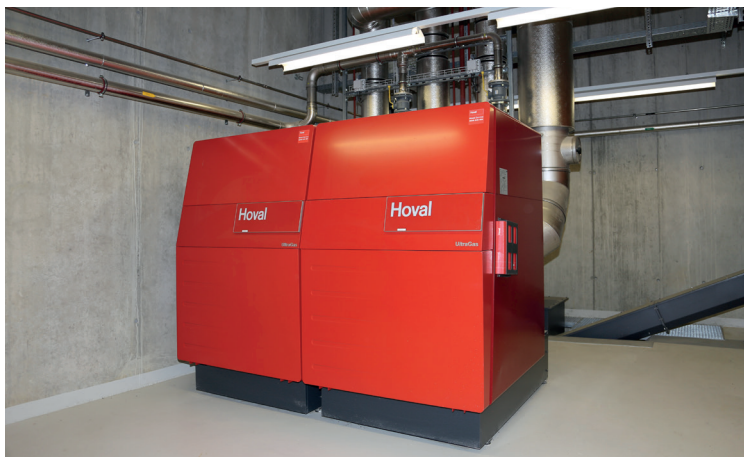
Centrale de chauffe pour réseau de chauffage à distance: 1 UltraGas double (1300D) garanti la plus grande efficacité et sécurité de fonctionnement.
