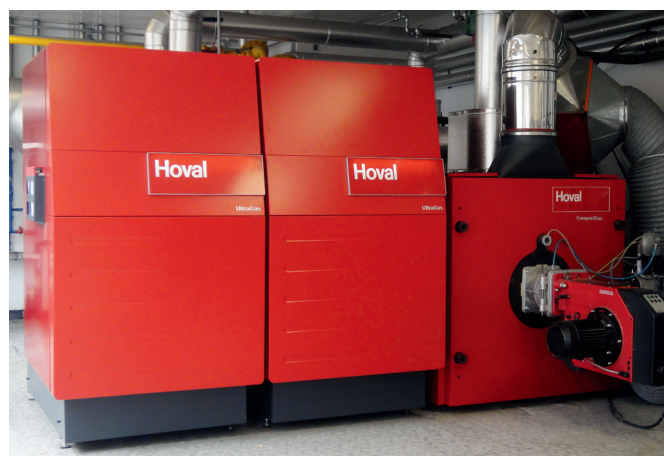
Cascade monovalente de 2 UltraGas® et d'1 CompactGas dans la centrale de chauffage.
