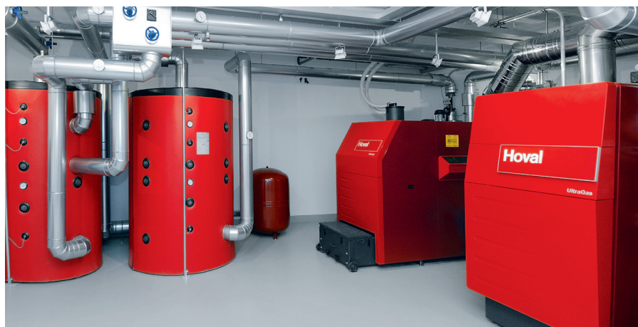
Cascade bivalente chaudière à pellets BioLyt (160) pour les besoins thermiques de base et chaudière gaz à condensation UltraGas® (250) pour couvrir les pics.
